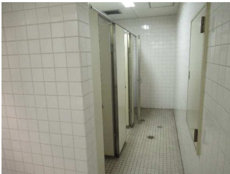
○女子便所 トイレブース
