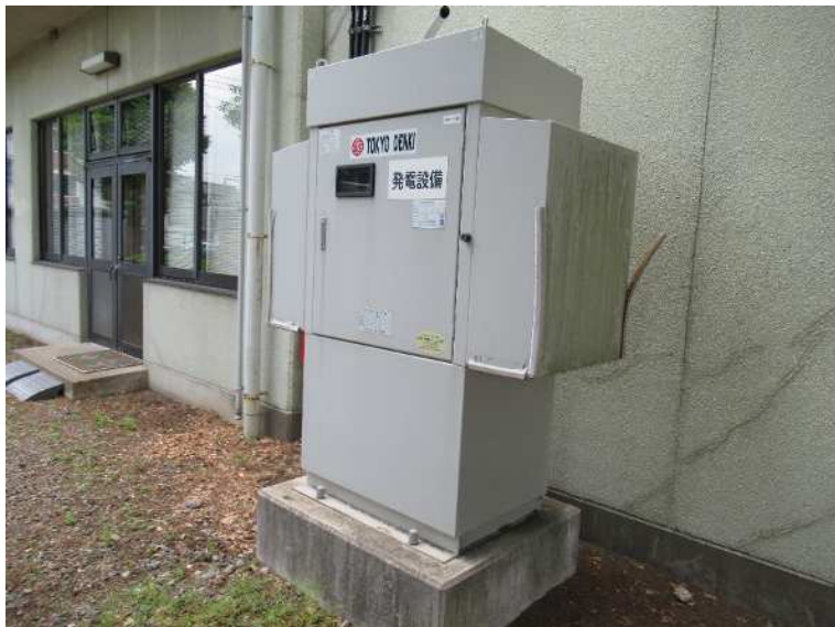
○自家発電設備
