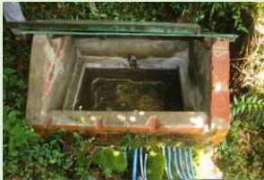
<分水槽 蓋を開けた所 H27撮影>
